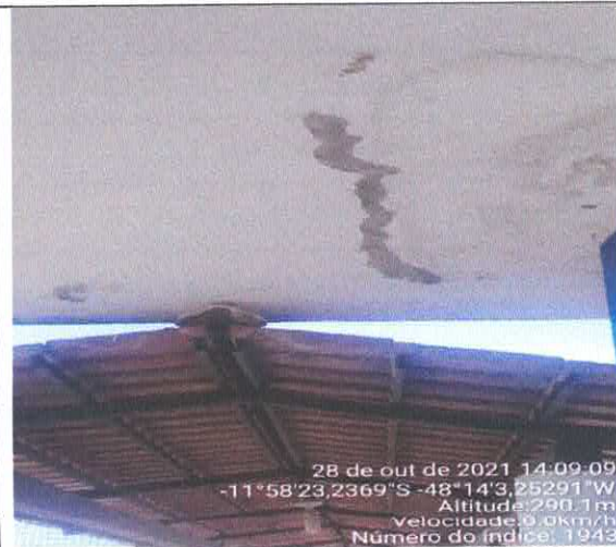
FOTO 16: INFILTRAÇÃO E PINTURA DETERIORADA DEVIDO AS COTEIRAS DO TELHADO
