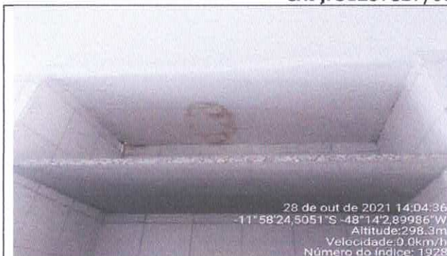
FOTO 21: INFILTRAÇÃO DE TETO
