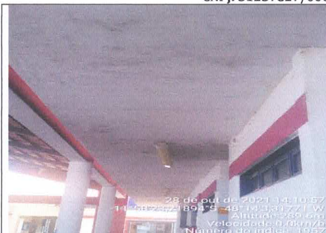
FOTO 11: INFILTRAÇÃO E PINTURA DETERIORADA DEVIDO AS COTEIRAS DO TELHADO
