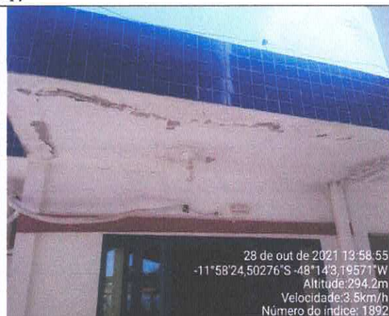
FOTO 12: INFILTRAÇÃO E PINTURA DETERIORADA DEVIDO AS COTEIRAS DO TELHADO
