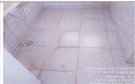
FOTO 22: INFILTRAÇÃO DE PAREDE E PISO
