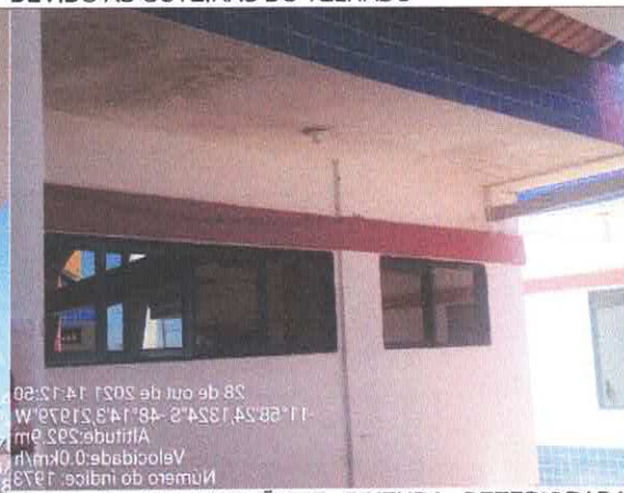
FOTO 14: INFILTRAÇÃO E PINTURA DETERIORADA DEVIDO AS COTEIRAS DO TELHADO
