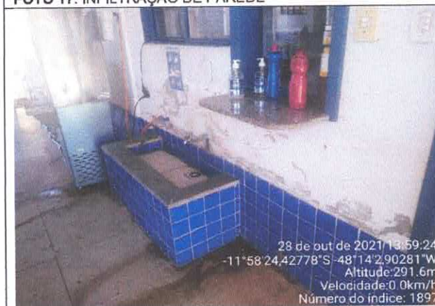
FOTO 19: INFILTRAÇÃO DE PAREDE E PISO
