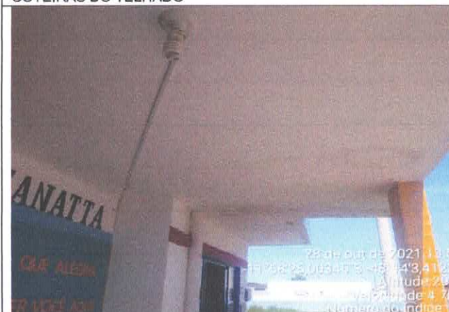
FOTO 13: INFILTRAÇÃO E PINTURA DETERIORADA DEVIDO AS COTEIRAS DO TELHADO
