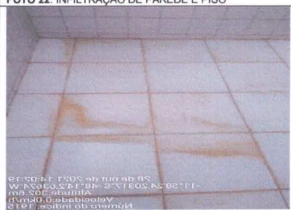
FOTO 24: INFILTRAÇÃO DE PISO
