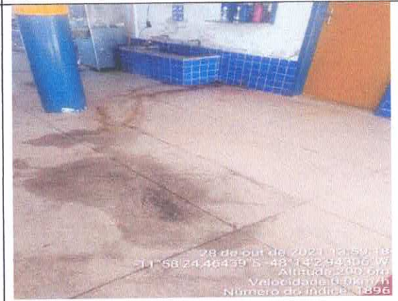
FOTO 20: INFILTRAÇÃO DE PAREDE E PISO
