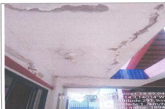
FOTO 3: INFILTRAÇÃO E PINTURA DETERIORADA DEVIDO AS COTEIRAS DO TELHADO
