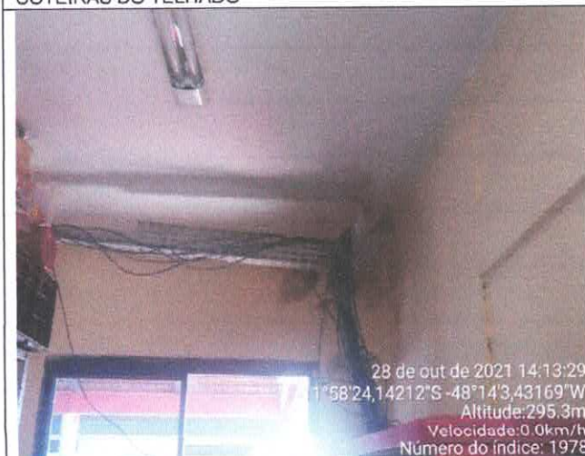
FOTO 15: INFILTRAÇÃO E PINTURA DETERIORADA DEVIDO AS COTEIRAS DO TELHADO
