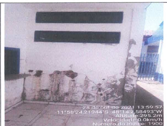
FOTO 18: INFILTRAÇÃO DE PAREDE E PISO
