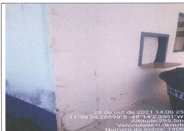
FOTO 17: INFILTRAÇÃO DE PAREDE
